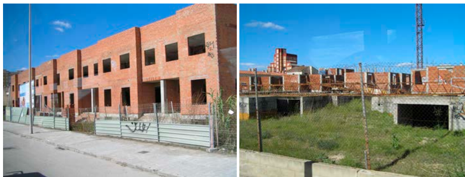
Figure 29, 30. Edifici in costruzione lungo i margini interni (confinanti con la CV 500) dell'insediamento di El Perello, a colmare gli ultimi lotti disponibili entro le 'areas edificadas' .
