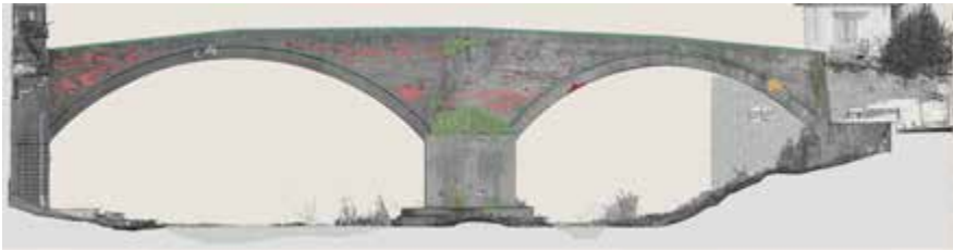
Fig. 13. Analisi del degrado del prospetto a valle
