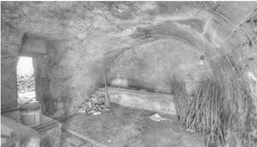
Fig. 2. Esempio di ambiente voltato rimasto integro dopo il sisma
